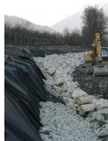
Protection de la berge RG, travaux définitifs en cours de réalisation (Novembre Février 2011).
