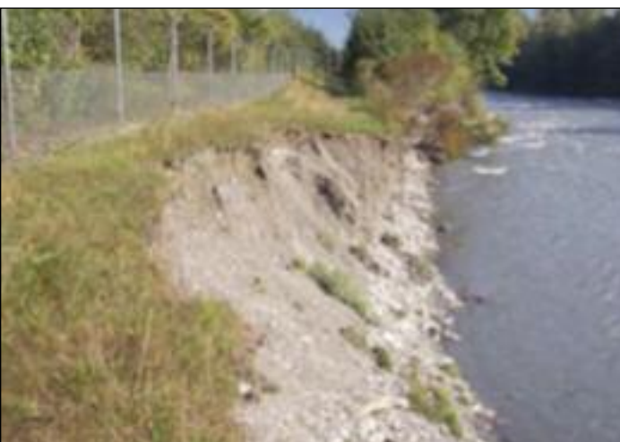
Berge RG au niveau de l'érosion, après la crue de mai 2008.
