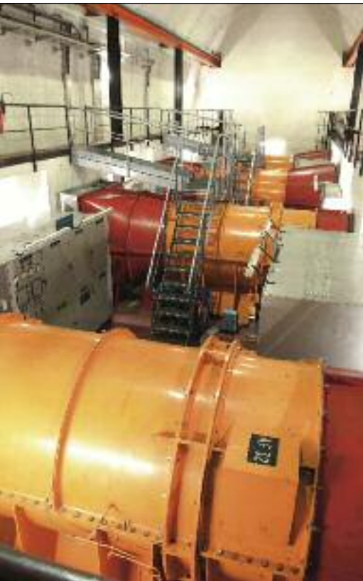
Ventilateurs d'air frais et d'air vicié
